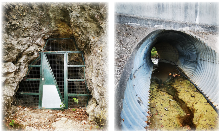
Figure 33 : Entrée de la grotte du Zoo du Lunaret (à gauche), Ouvrage hydraulique 8 de la RD112 (Pépinère 1982) (à droite)
